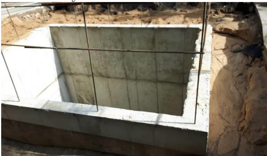
Rys. 7. Komora mikrotunelinguowa odbiorcza żelbetonowa źródło: Archiwum własne autora.
