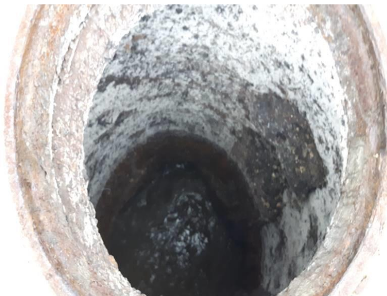
Rys. 1. Skorodowana komora betonowa kanalizacyjna źródło: fot. własna autora 2017
