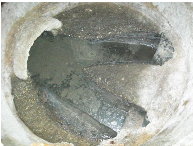
Rys. 5. Skorodowana studnia rozprężna DN2000mm źródło fot. własna autora (2016).
