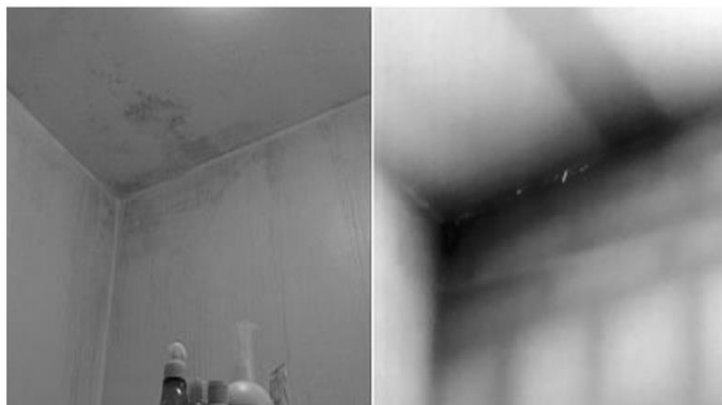
Rys. 2. Badanie termowizyjne naroża zajętego przez pleśń ( www.termocert.com.pl ).
