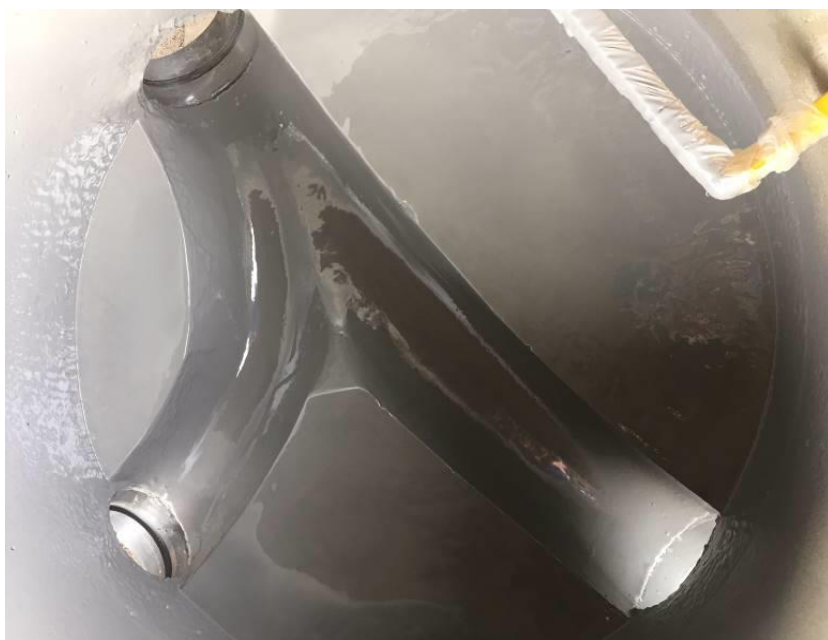
Rys. 2. Studnia kanalizacyjna zabezpieczona fabrycznie polimocznikiem źródło: Coatreno Sp. z o.o. 2017
